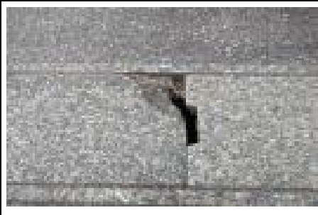
①側溝の蓋の角が欠けている為、歩行時につまずきやすい。
