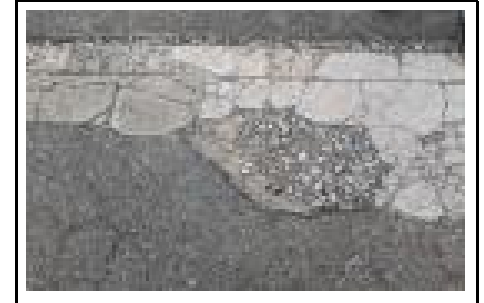
④学校敷地内のプールの横で溝が出来ている為、つまずきやすい
