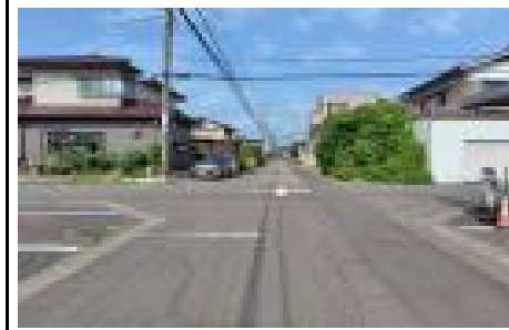
③ラピス付近の交差点 (車・自転車の交通量が多いうえに停止線が消えかかっている)
